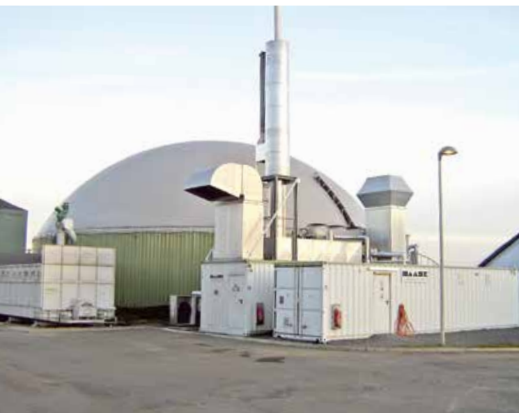
Рис. 2. Загальний вигляд біогазової установки біоенергетичного селища Юнде
