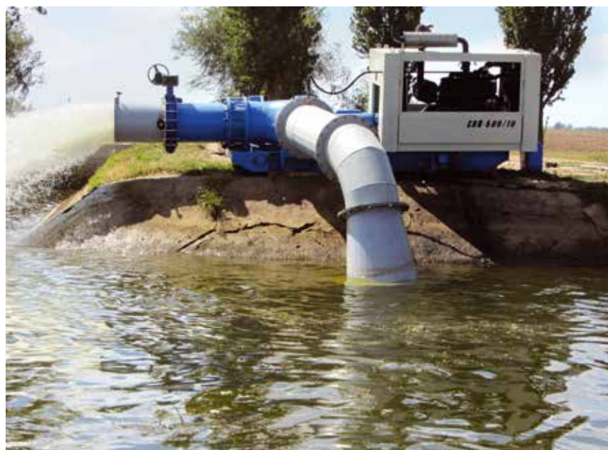
Рис. 5. Насосна станція СНП 500-10 (ПП «Агроводмаш, м. Херсон»)
