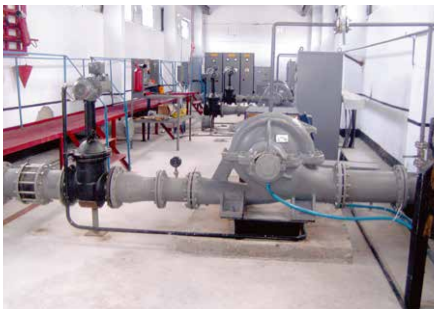
Рис. 1. Електрична насосна станція стаціонарного розміщення
