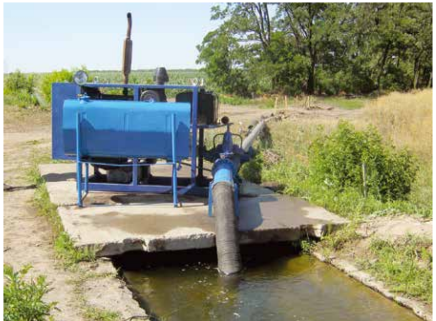
Рис. 3. Пересувна насосна станція з дизельним приводом АНД 300-60 (ТОВ «ТД-Н.К. Енергомаш», м. Н. Каховка)
